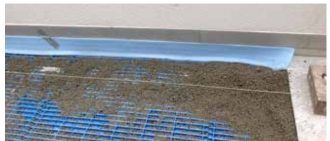
Verarbeitung von Granitplatten in gebundener Bauweise auf Drainagematten. Im Randanschlussbereich bei Isolierungshochzug wurde ein Dämmstreifen eingelegt.
