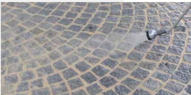
Wird der Fugenverschluss mit viel Wasser eingeschwennt gibt es kaum Setzungen in der Fuge.
